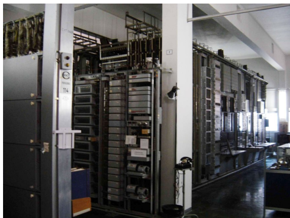
Vue de la salle « commutation »
